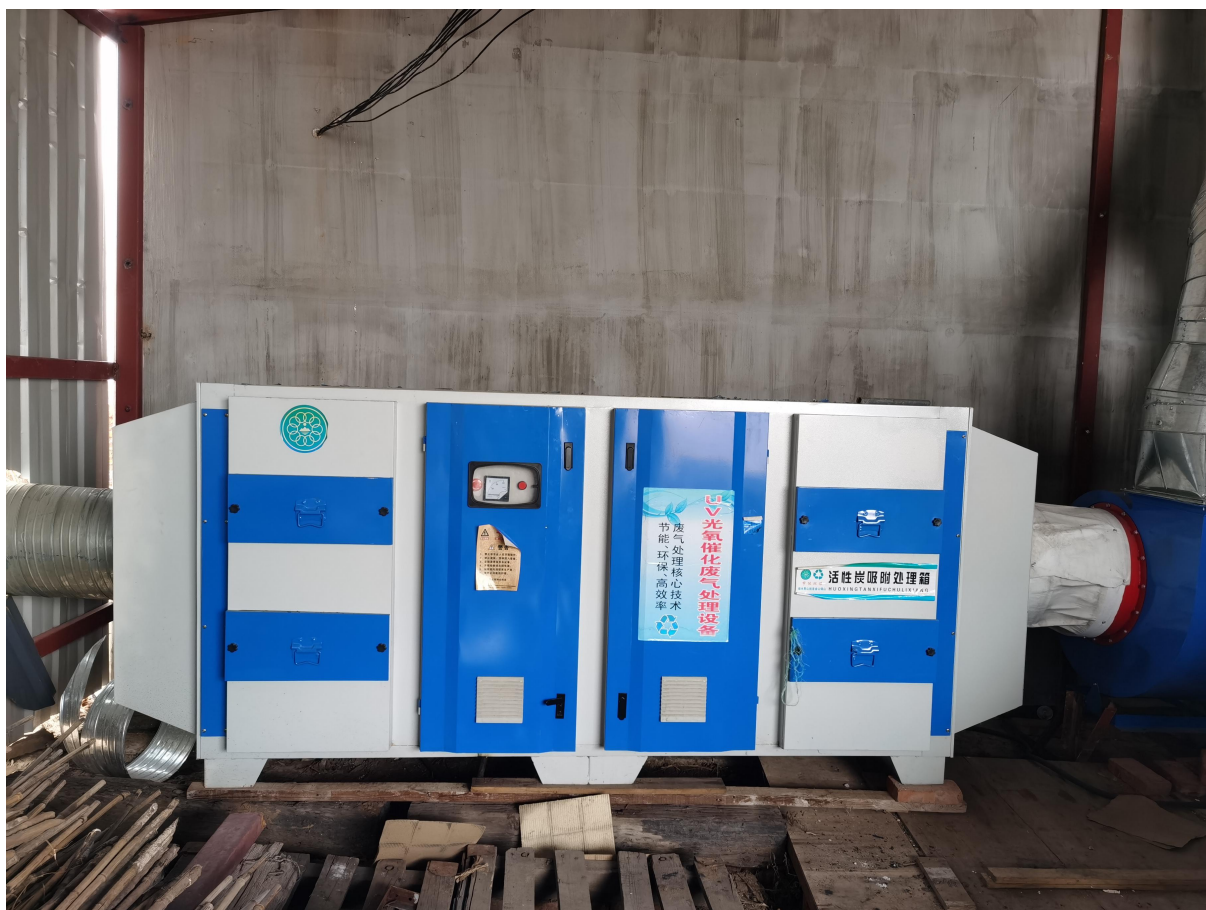
车间废气净化装置
