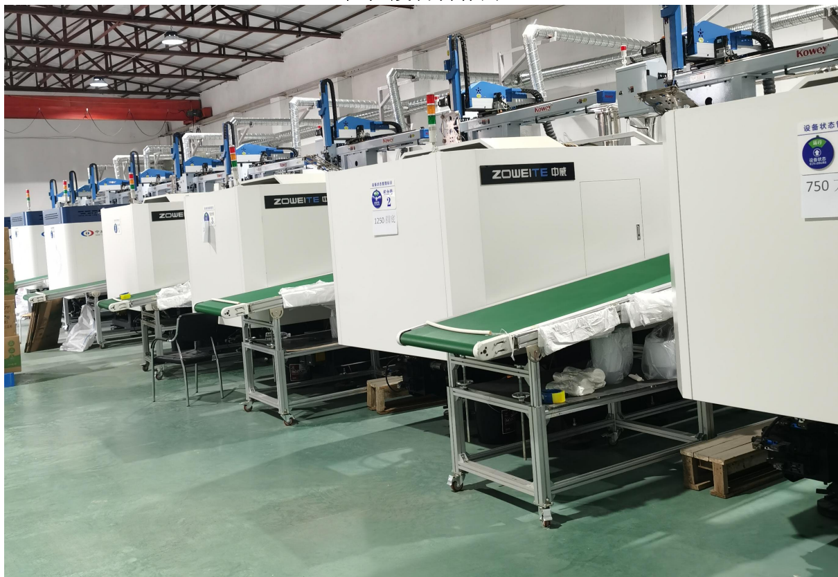
车间集气装置及地面防渗
